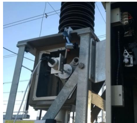
Цифровой датчик угловых перемещений, смонтированный на элегазовый выключатель ABB LTB 245 кВ
