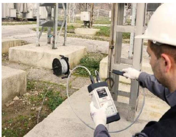
Испытание целостности контура заземления с RMO-ЕН
