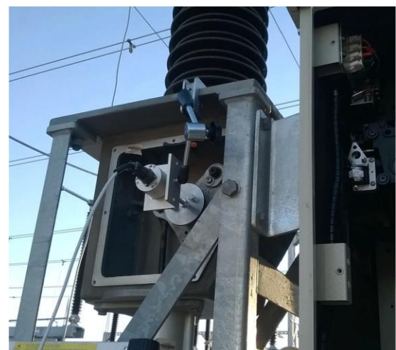
Рисунок 2: Цифровой датчик угловых перемещений, смонтированный на элегазовый выключатель ABB LTB 245 кВ
